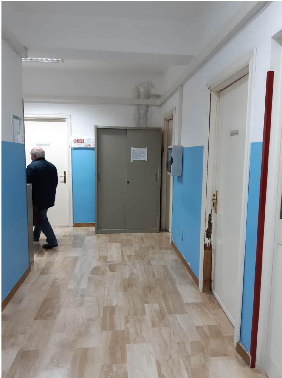
Figura 9. Particolare situazioni di ammaloramento interno
